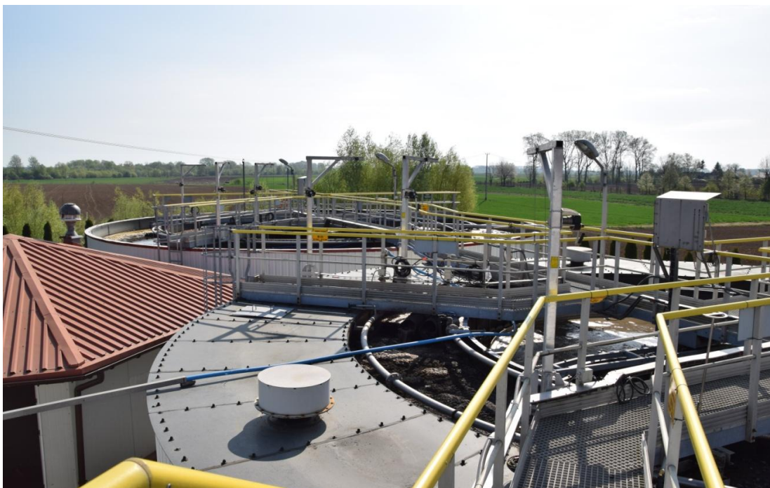
Fotografia 2. Zmodernizowana oczyszczalnia ścieków w Wierzawicach w gminie Leżajsk
